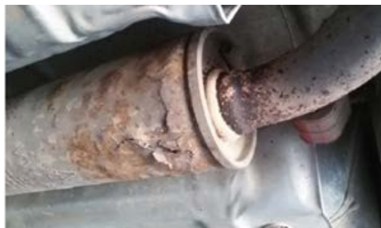
Рис. 2. Коррозия выхлопной системы
