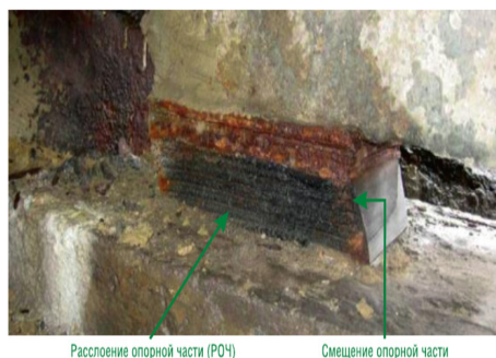
Рис. 2. Повреждение резино-металлической опорной части (РОЧ)
