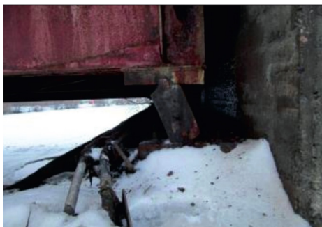
Рис. 1. Недопустимый наклон катка опорной части
