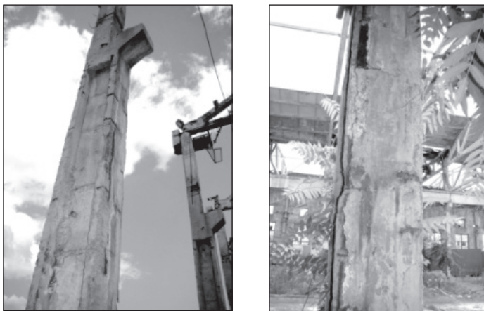
Рис. 2. Поврежденные колонны двутаврового профиля
