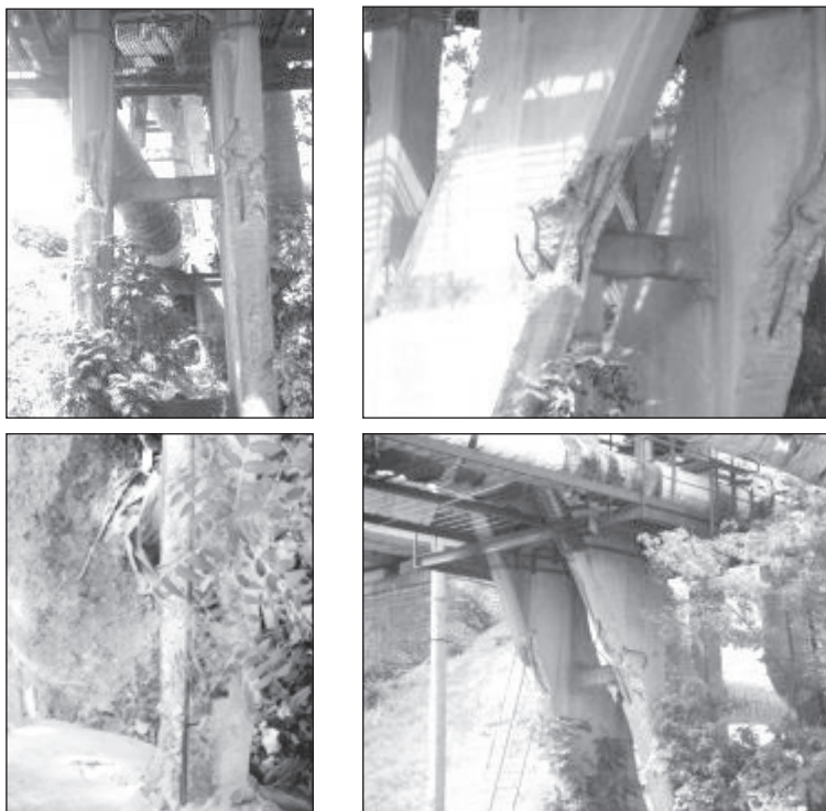
Рис. 1. Повреждения железобетонных опор транспортных сооружений
