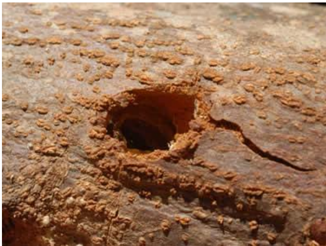
Отверстие с буровой мукой
